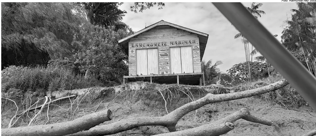
Mais de 300 famílias já saíram da comunidade Vila Progresso, devido às "terras caídas"
