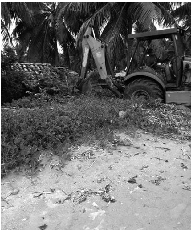
Derrubada dos ranchos de pesca em Porto de Pedra (AL) utiliza trator alugado de construtora
